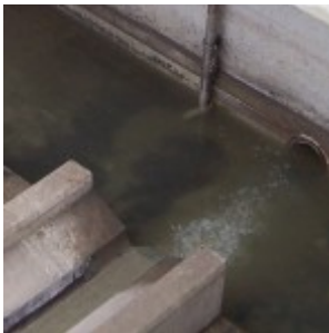
Füllstandsmessung über NivuBar Plus im RÜB
