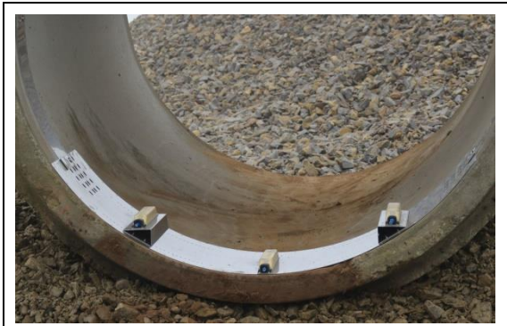
Tôles installées avec capteurs CS2
