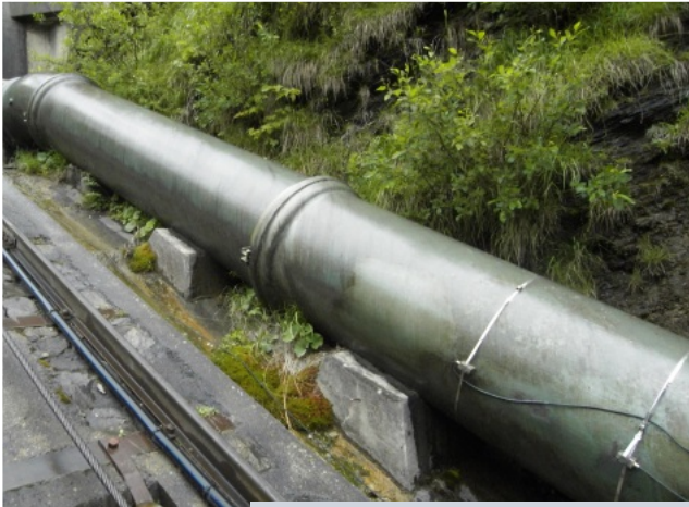
Mesure de débit avec capteurs sans contact clamp-on en entrée de turbine
